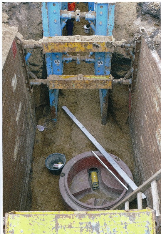
Schachtunterteile aus HL-Beton kommen in Delitzsch in Nennweite DN 1000 zum Einsatz.
